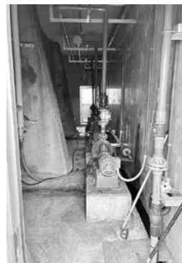
右図…ブロワー機の確認
